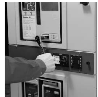
Levering Magnum DS Breaker
