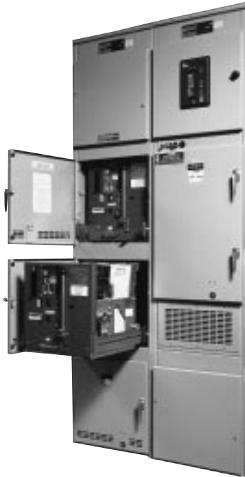
DS Switchgear Assembly
